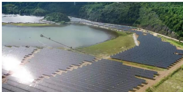
2024年3月，集团个旧背阴山尾矿库分布式光伏发电项目实现全容量并网发电。
